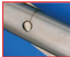
Sprekk i hengsel
